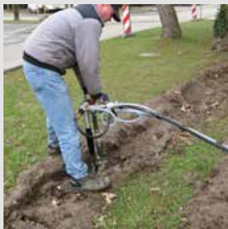
Einsatz bei Flurschäden durch Fahrzeugbewegung
