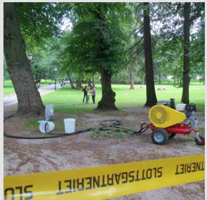
Sonderprojekt in Norwegen im Jahr 2013 Special project in Norway 2013
