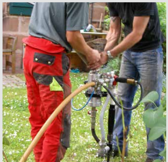
Befüllen des Behälters mit Feststoffen filling the container with solid material
